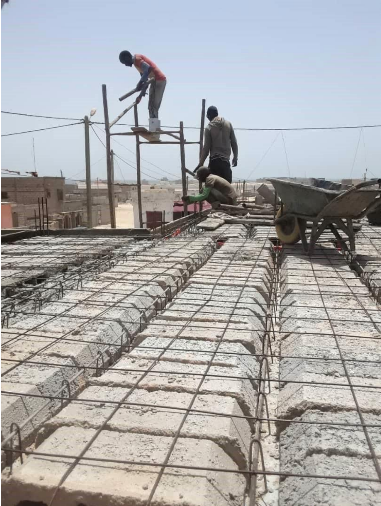
Betonvlochtwerk voor het dak van nieuwe gebouw. Het wordt dak wordt stevig genoeg gemaakt om er later eventueel nog een verdieping op te kunnen zetten.
